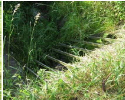
Einlaufgitter vor der L 1152
