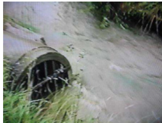
Der vorbeiströmende Dammbach verhindert, dass das Wasser aus dem RÜB I fließen kann
