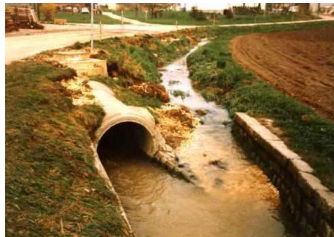
Auslauf des Regenüberlaufbeckens am nächsten Morgen
