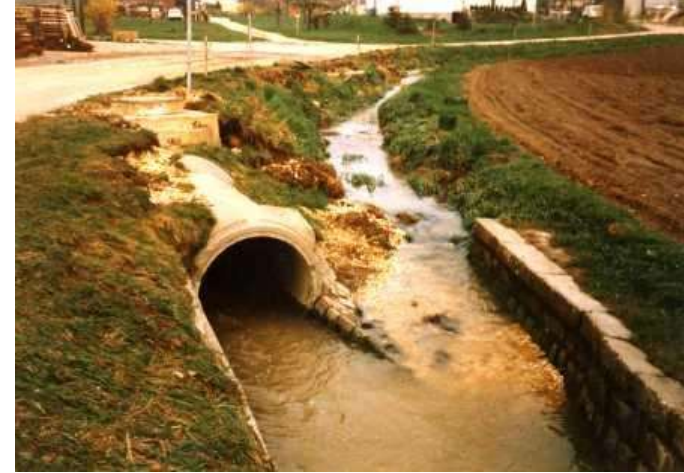
Auslauf des Regenüberlaufbeckens am nächsten Morgen
